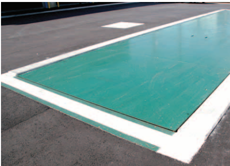
▲計量機まわりは水の浸入を防ぐため、一段高くなっている。
