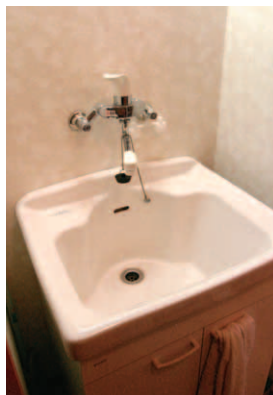
▲脱衣室には、洗いのものに便利な深めのシンク。
