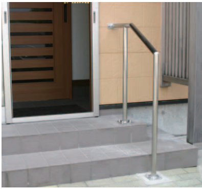
▲玄関のポーチに取り付けた手すり。
