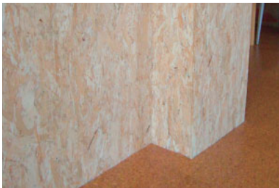
壁と床の境界に巾木がない
