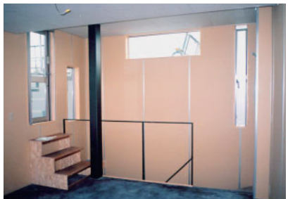
石膏ボードの上にクロスは貼られていない
